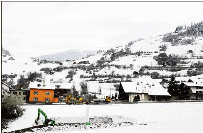
La lingia da tensiun aulta traversa il territori da Demvitz a Laax. El futur vegn quella transferida en in foss. Aunc ussa vegnan mo ils bischels vits mess el foss.
